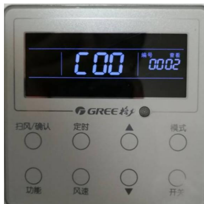
图 7 通过有线遥控器查询格力空调室内机地址
